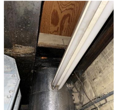
Air Ejector Pipe Bottom
